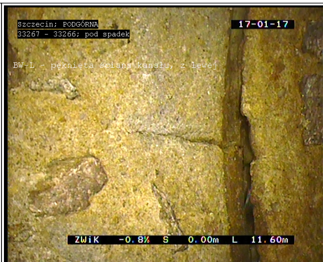
11.59 m - BW-L - pęknięta ściana kanału, z lewej
