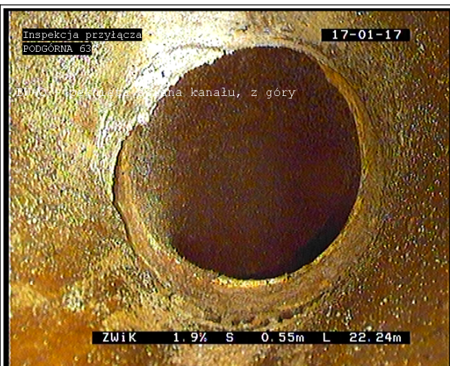
0.55 m - BW-O - pęknięta ściana kanału, z góry
