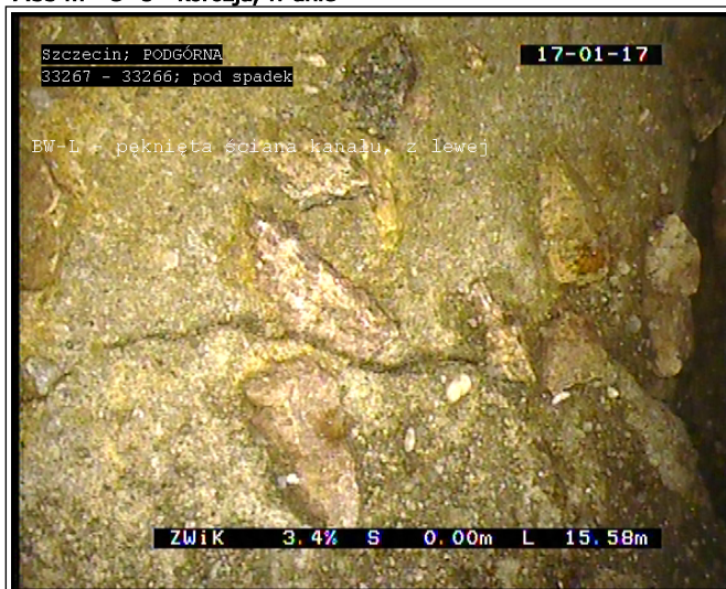
15.58 m - BW-L - pęknięta ściana kanału, z lewej
