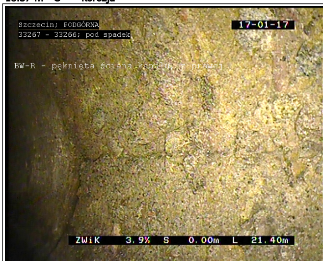
21.40 m - BW-R - pęknięta ściana kanału, z prawej
