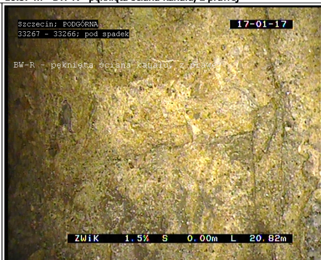
20.82 m - BW-R - pęknięta ściana kanału, z prawej
