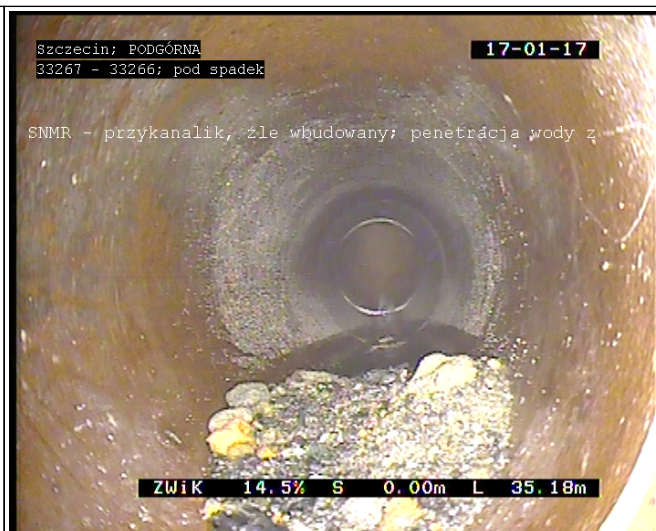
35.18 m - SNMR - przykanalik, źle wbudowany; penetracja wody z ziemią, przykanalik, z prawej
