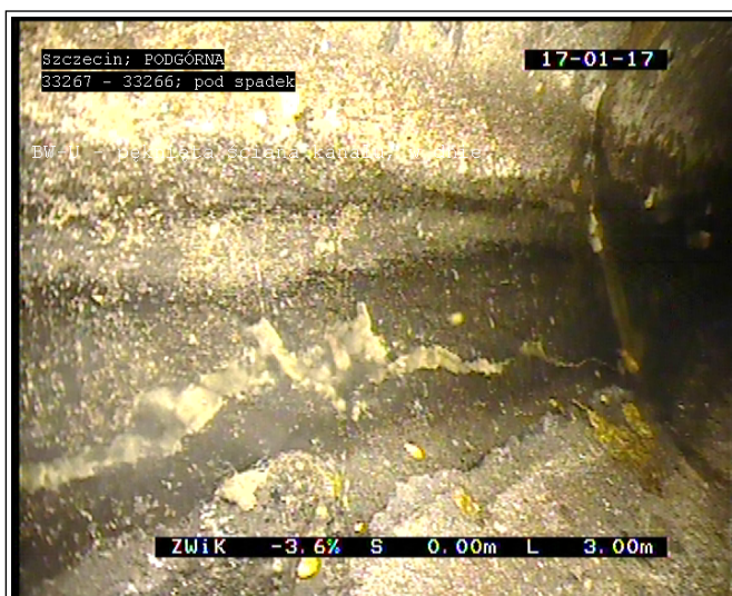
3.00 m - BW-U - pęknięta ściana kanału, w dnie
