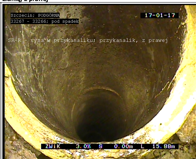
15.88 m - SR-R - rysa w przykanaliku; przykanalik, z prawej
