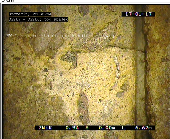
6.67 m - BW-L - pęknięta ściana kanału, z lewej
