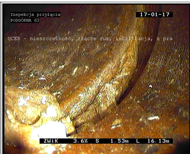
1.53 m - UCER - nieszczelność, złącze rur, infiltracja, z prawej
