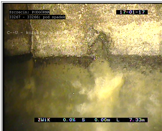
7.33 m - C--U - korozja, w dnie
