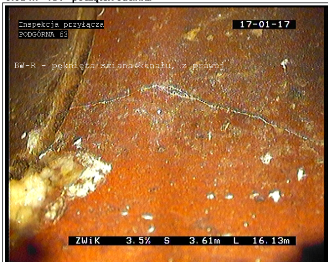
3.61 m - BW-R - pęknięta ściana kanału, z prawej
