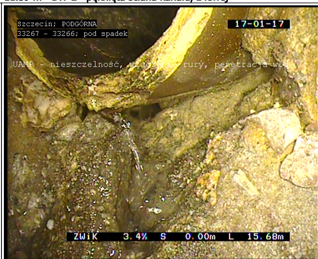
15.68 m - UAMR - nieszczelność, włączenie rury, penetracja wody z ziemią, z prawej
