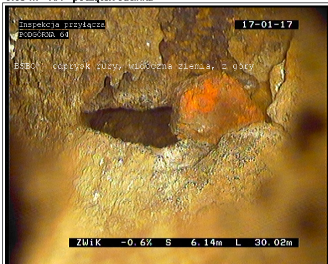
6.14 m - BSBO - odprysk rury, widoczna ziemia, z góry
