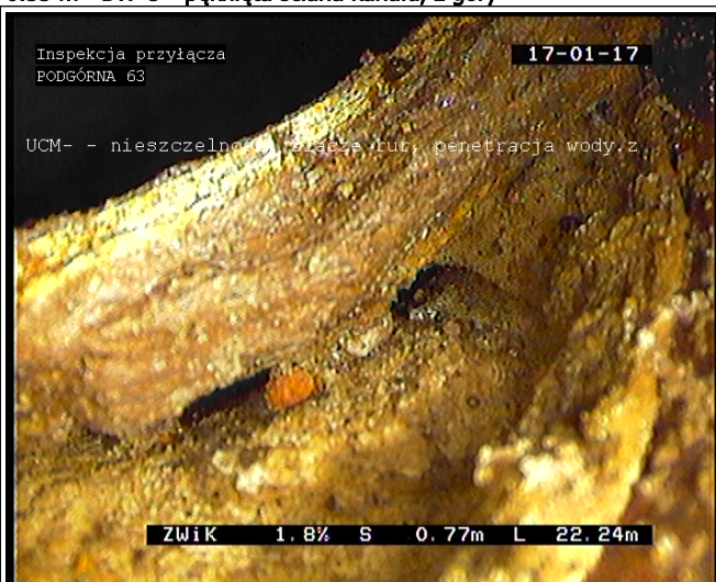
0.77 m - UCM- - nieszczelność, złącze rur, penetracja wody z ziemią
