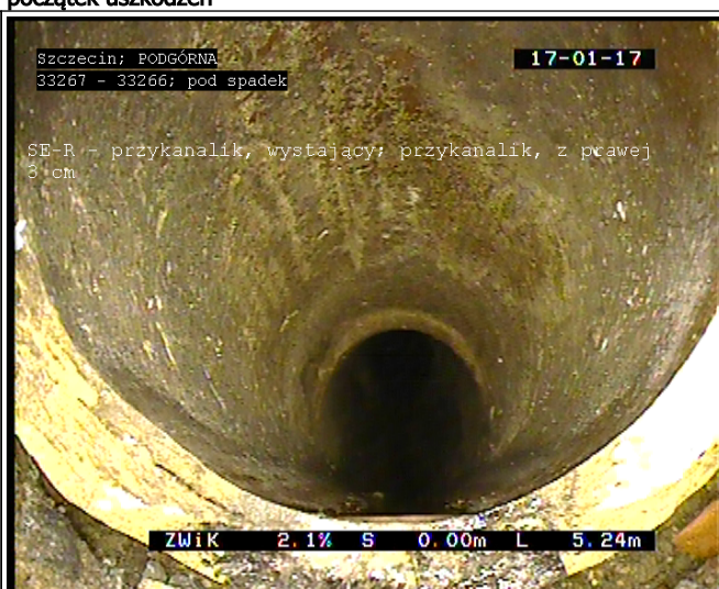
5.24 m - SE-R - przykanalik, wystający; przykanalik, z prawej 3 cm
