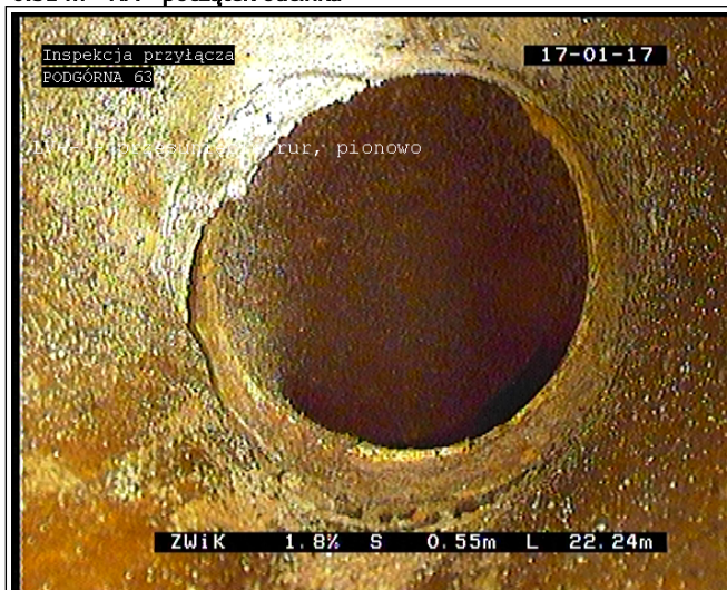
0.55 m - LV-- - przesunięcie rur, pionowo
