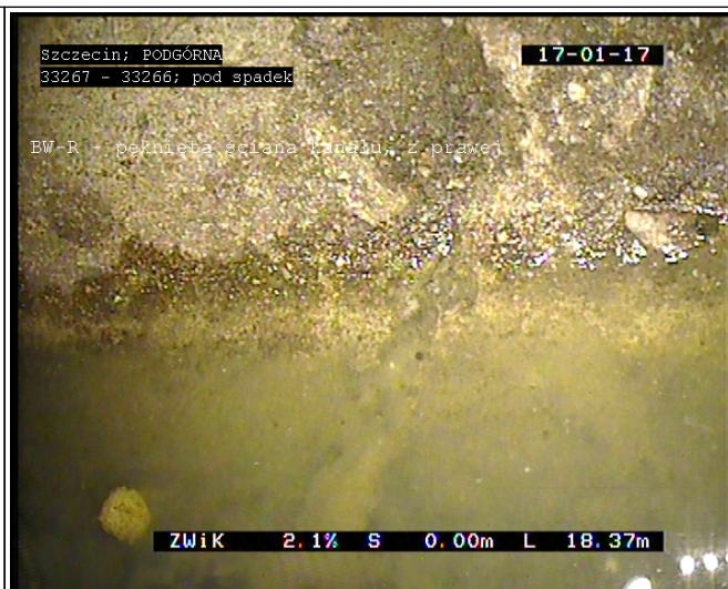
18.37 m - BW-R - pęknięta ściana kanału, z prawej
