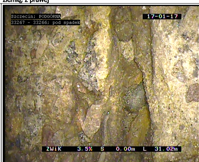
31.02 m - C--- - korozja
