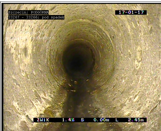
2.45 m - C--- - korozja początek uszkodzeń
