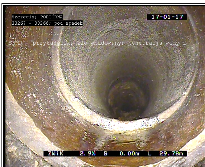
29.78 m - SNMR - przykanalik, źle wbudowany; penetracja wody z ziemią, przykanalik, z prawej
