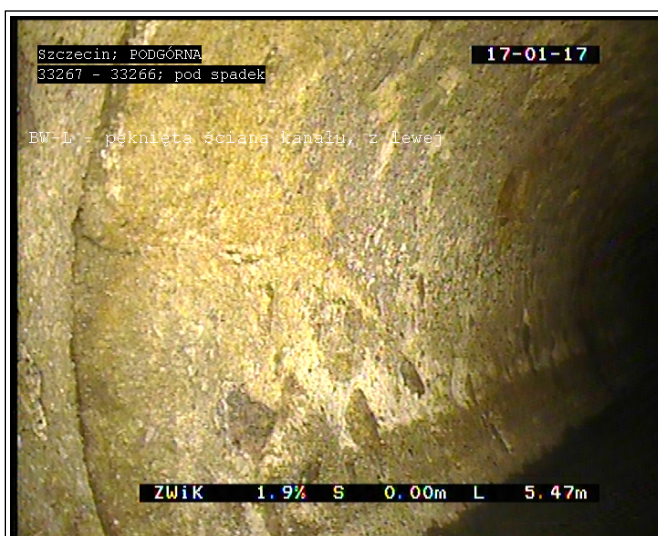
5.47 m - BW-L - pęknięta ściana kanału, z lewej
