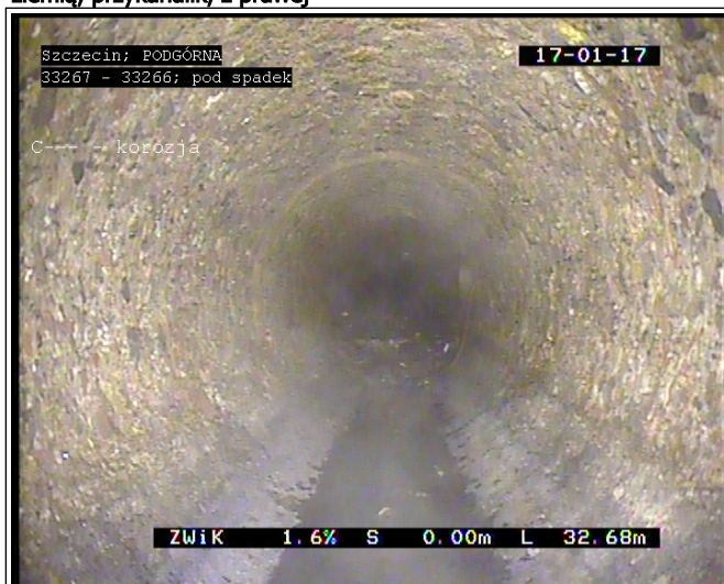
32.68 m - C--- - korozja
