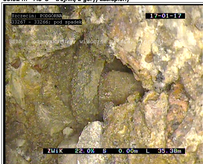
35.38 m - BSBR - odprysk rury, widoczna ziemia, z prawej
