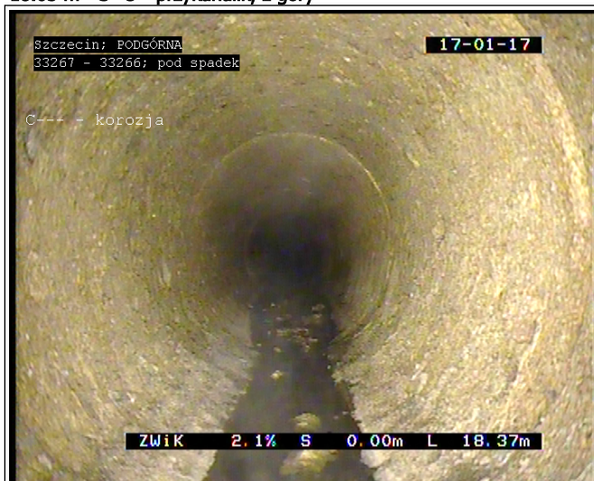
18.37 m - C--- - korozja
