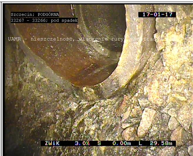
29.58 m - UAMR - nieszczelność, włączenie rury, penetracja wody z ziemią, z prawej
