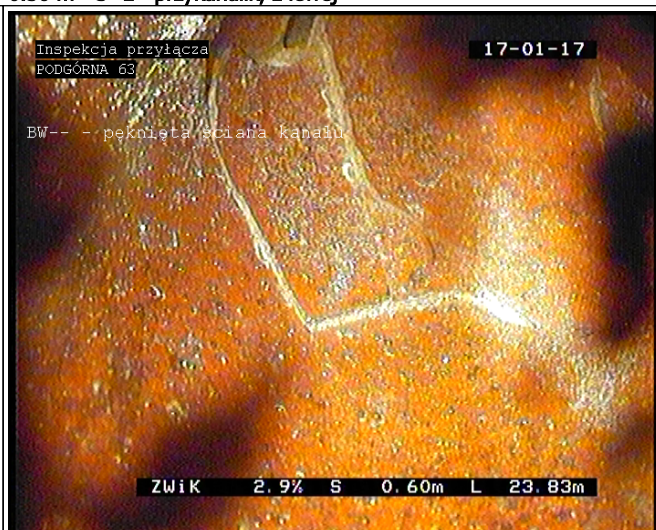
0.60 m - BW-- - pęknięta ściana kanału
