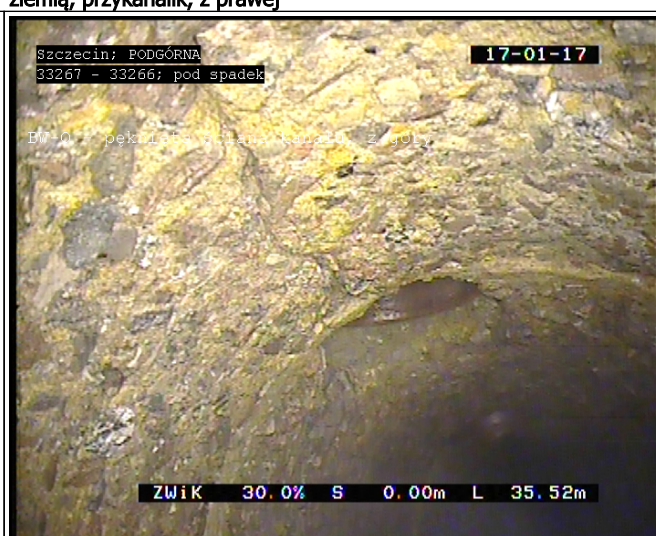
35.52 m - BW-O - pęknięta ściana kanału, z góry
