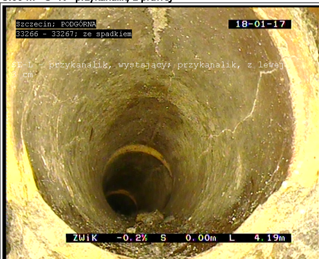
4.19 m - SE-L - przykanalik, wystający; przykanalik, z lewej 3 cm
