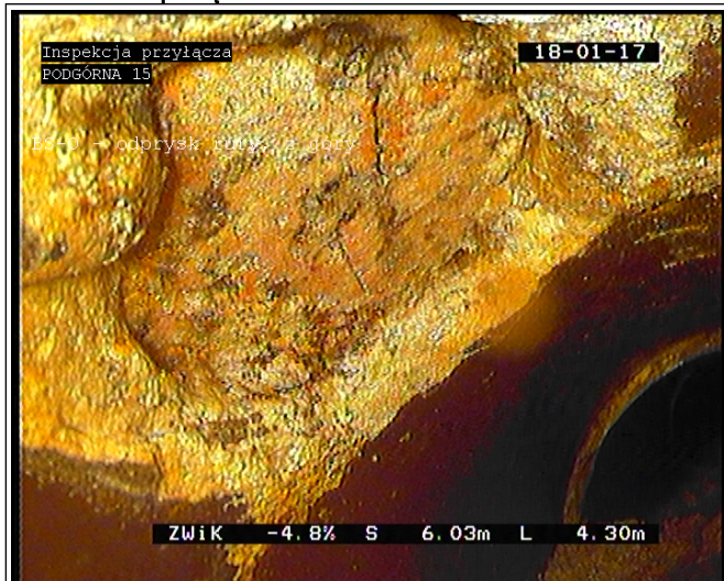
6.03 m - BS-O - odprysk rury, z góry
