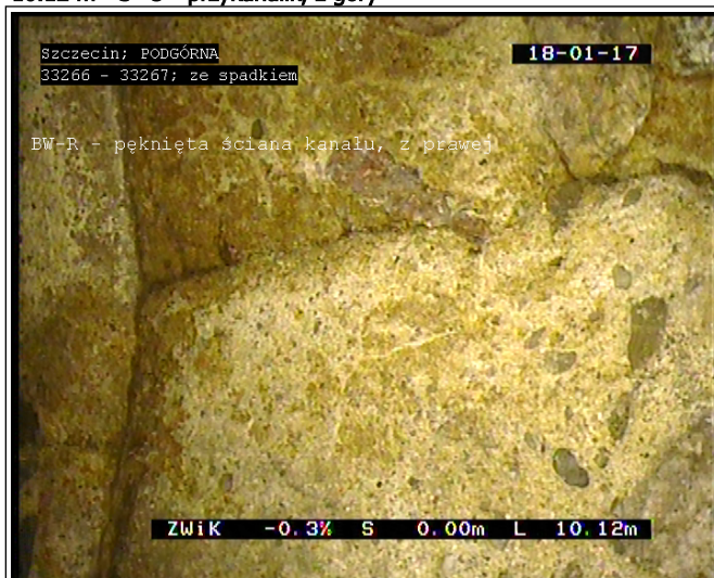
10.12 m - BW-R - pęknięta ściana kanału, z prawej
