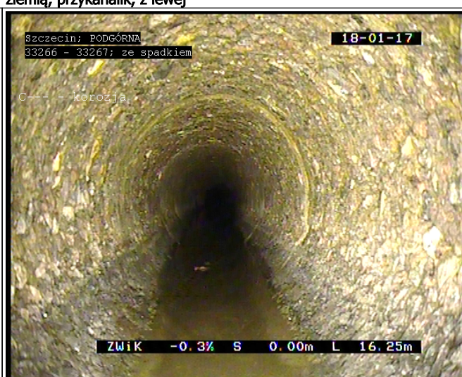
16.24 m - C--- - korozja
