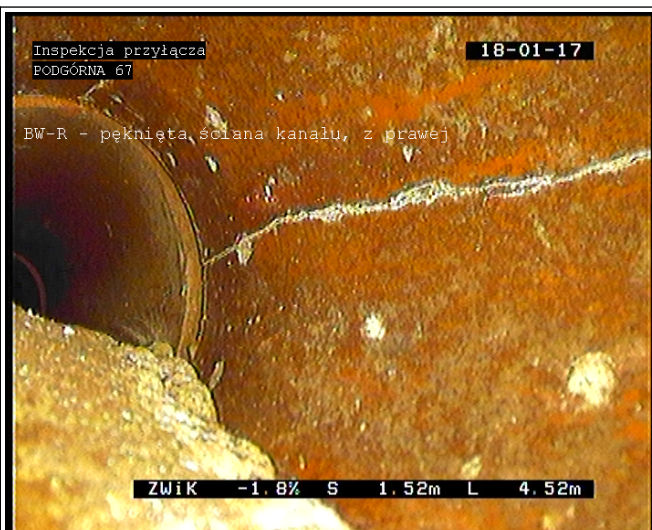
1.52 m - BW-R - pęknięta ściana kanału, z prawej
