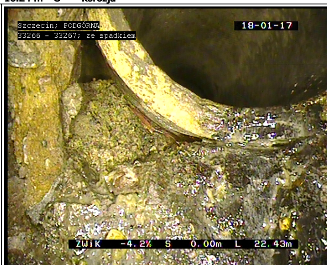
22.42 m - UABL - nieszczelność, włączenie rury, widoczna ziemia, z lewej
