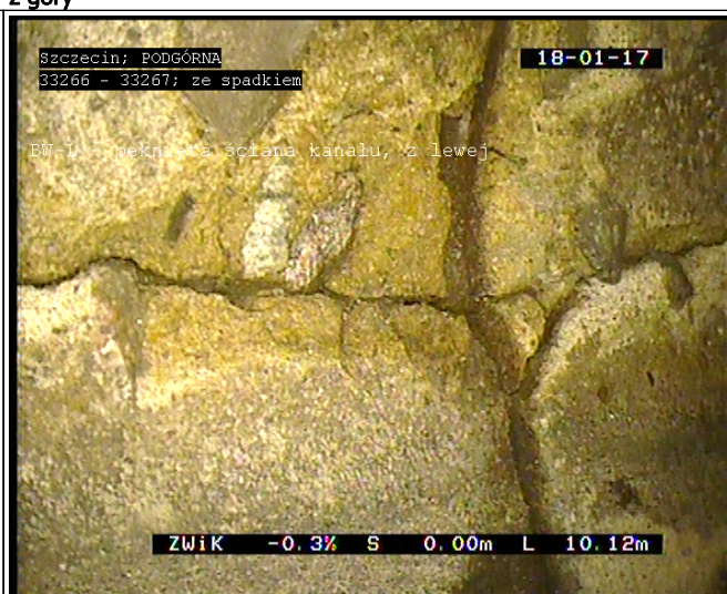
10.12 m - BW-L - pęknięta ściana kanału, z lewej
