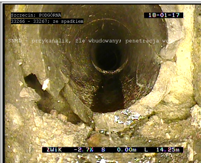
14.25 m - SNML - przykanalik, źle wbudowany; penetracja wody z ziemią, przykanalik, z lewej
