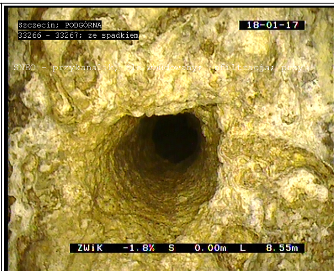
8.53 m - SNEO - przykanalik, źle wbudowany; infiltracja; przykanalik, z góry
