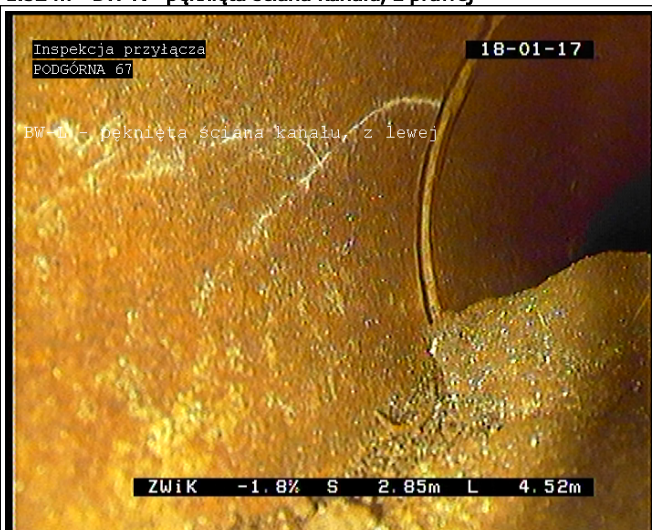
2.85 m - BW-L - pęknięta ściana kanału, z lewej
