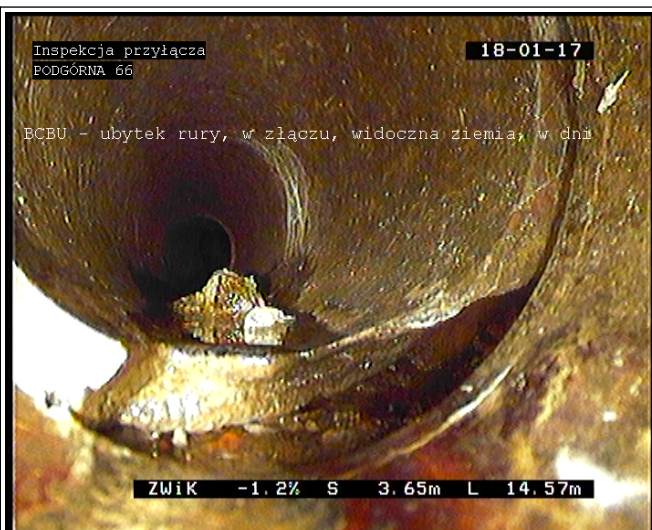
3.65 m - BCBU - ubytek rury, w złączu, widoczna ziemia, w dnie
