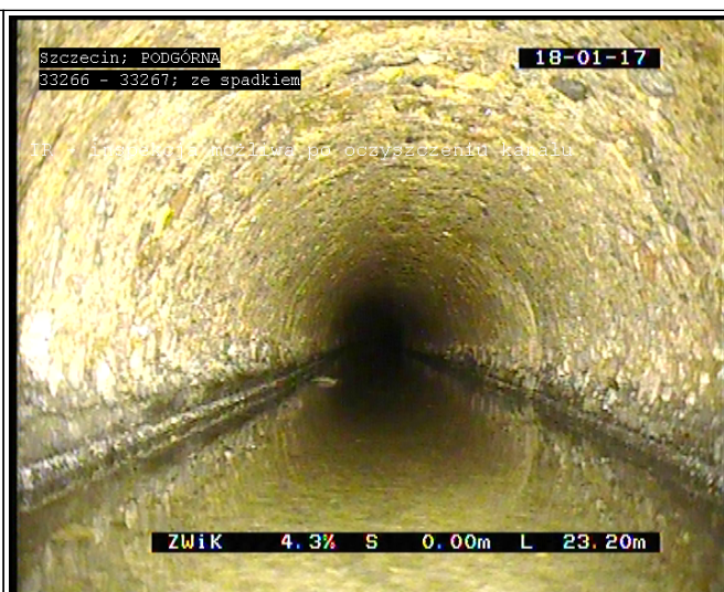
23.20 m - IR - inspekcja możliwa po oczyszczeniu kanału
