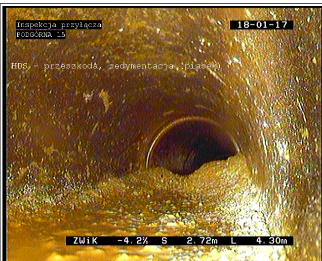
2.72 m - HDS - przeszkoda, sedimentacja (piasek)
