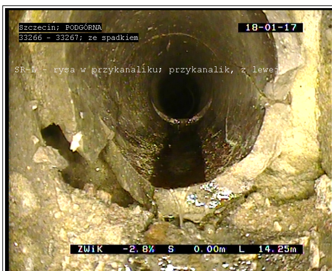
14.25 m - SR-L - rysa w przykanaliku; przykanalik, z lewej
