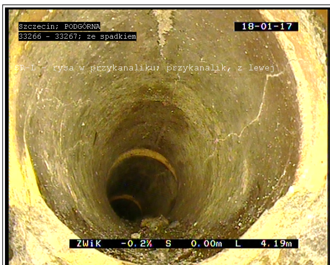
4.19 m - SR-L - rysa w przykanaliku; przykanalik, z lewej
