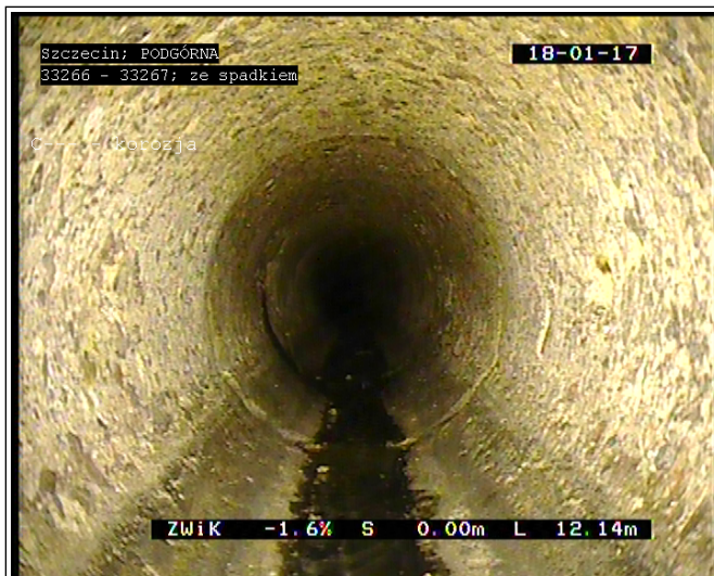
12.14 m - C--- - korozja
