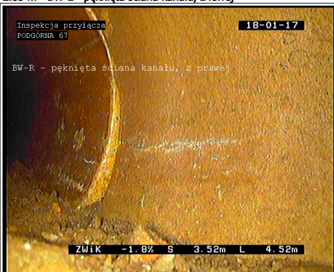
3.52 m - BW-R - pęknięta ściana kanału, z prawej
