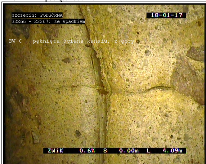
4.09 m - BW-O - pęknięta ściana kanału, z góry
