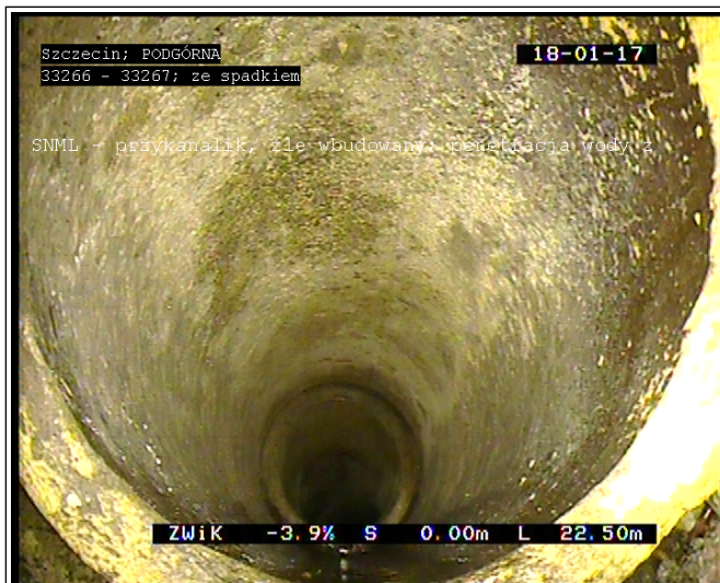
22.49 m - SNML - przykanalik, źle wbudowany; penetracja wody z ziemią, przykanalik, z lewej
