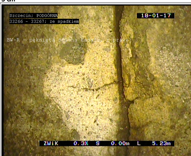
5.23 m - BW-R - pęknięta ściana kanału, z prawej
