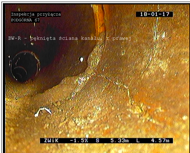
5.33 m - BW-R - pęknięta ściana kanału, z prawej
