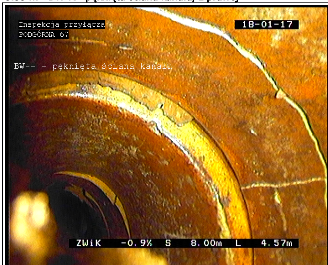
8.00 m - BW-- - pęknięta ściana kanału
