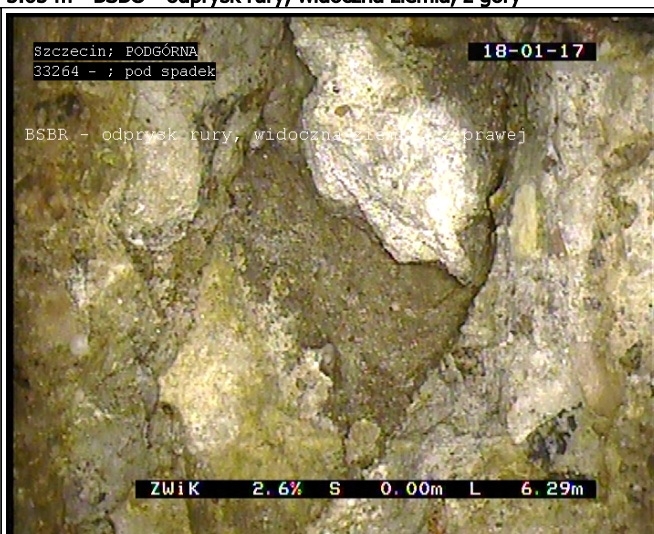
6.29 m - BSBR - odprysk rury, widoczna ziemia, z prawej
