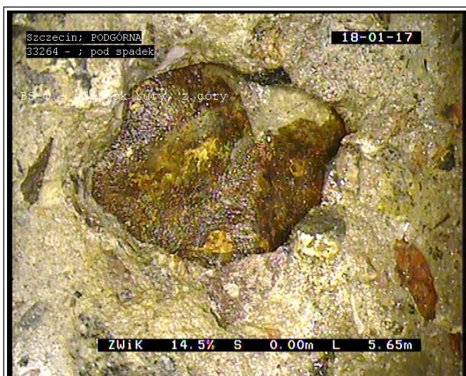
5.65 m - BS-O - odprysk rury, z góry
