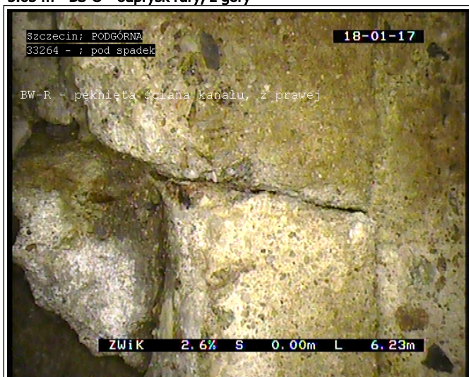
6.23 m - BW-R - pęknięta ściana kanału, z prawej
