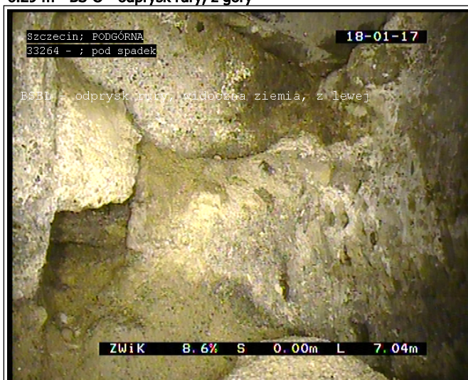
7.04 m - BSBL - odprysk rury, widoczna ziemia, z lewej
