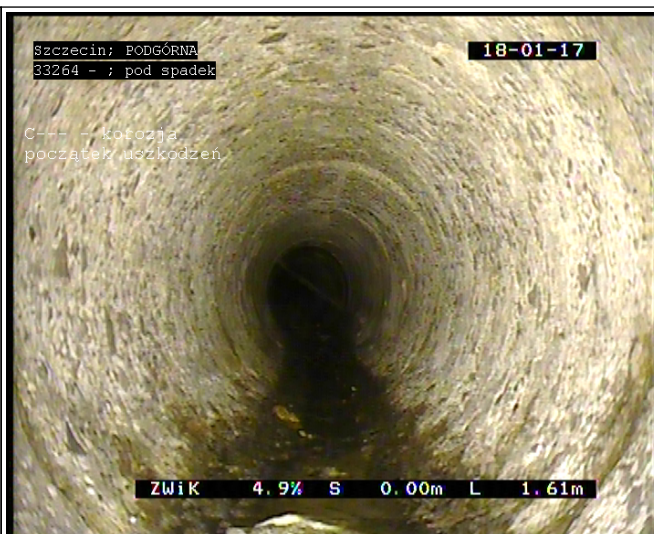
1.61 m - C--- - korozja początek uszkodzeń
