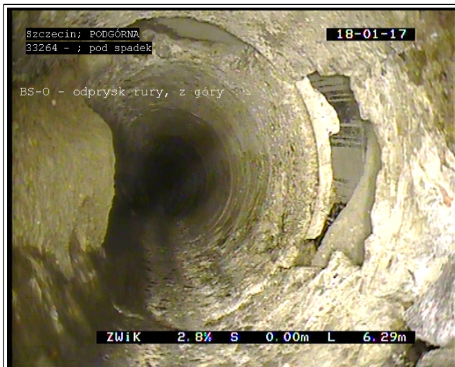
6.29 m - BS-O - odprysk rury, z góry
