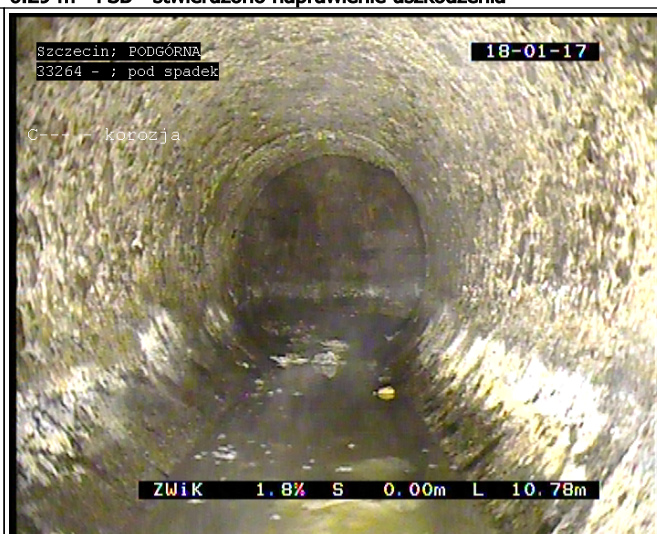
10.78 m - C--- - korozja
