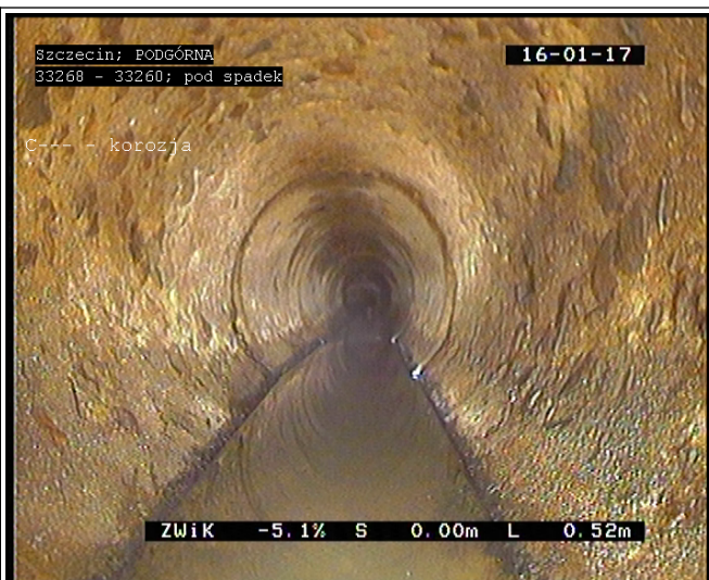
0.52 m - C--- - korozja początek uszkodzeń
