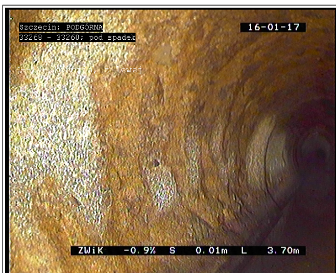
3.70 m - C-L - korozja, z lewej
