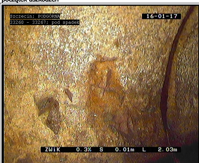
2.03 m - C--- - korozja
