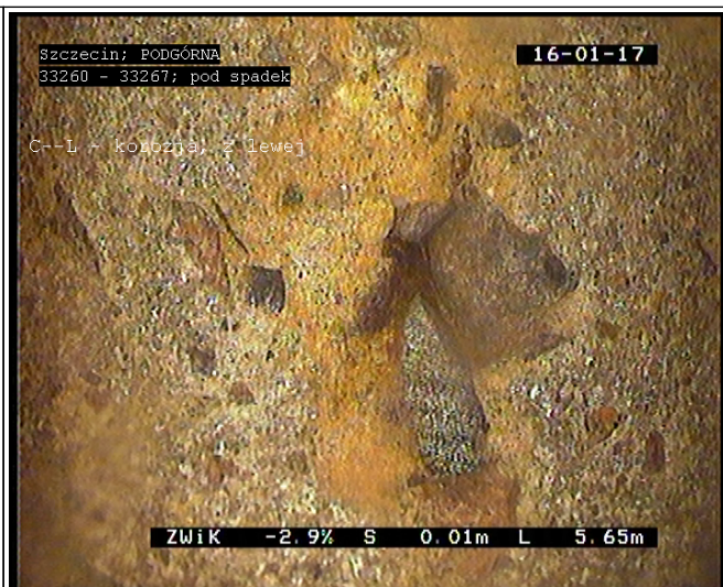
5.65 m - C--L - korozja, z lewej
