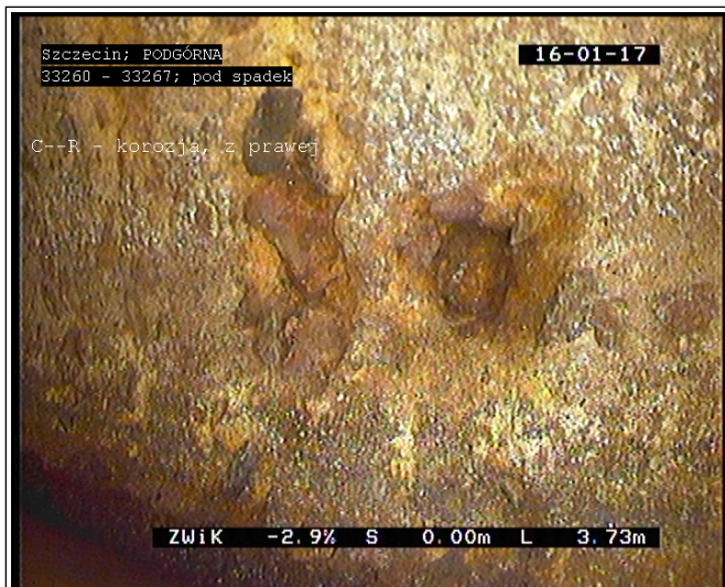
3.72 m - C--R - korozja, z prawej
