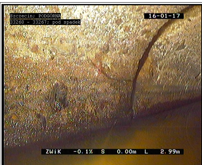
2.99 m - BW-L - pęknięta ściana kanału, z lewej
