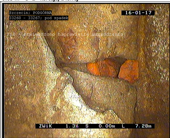
7.28 m - FSB - stwierdzono naprawienie uszkodzenia
