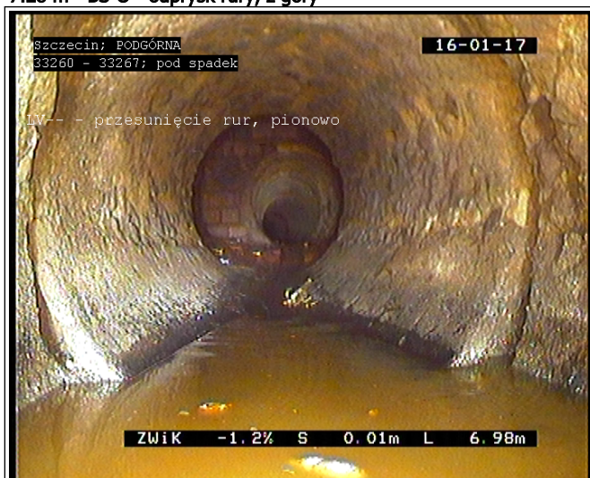
6.98 m - LV-- - przesunięcie rur, pionowo
