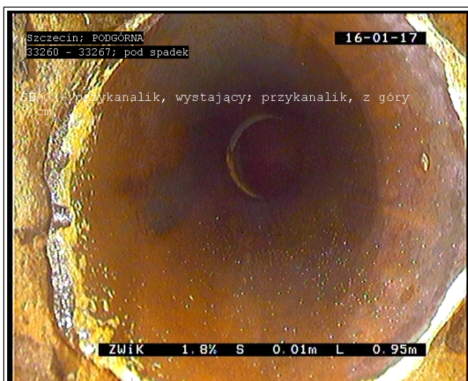
0.95 m - SE-O - przykanalik, wystający; przykanalik, z góry 3 cm
