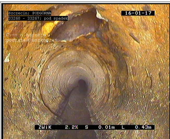
0.43 m - C--- - korozja początek uszkodzeń
