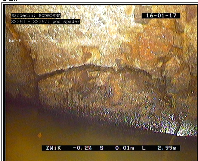
2.99 m - BW-R - pęknięta ściana kanału, z prawej
