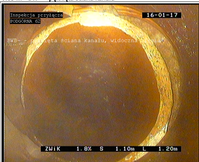
1.10 m - BWB- - pęknięta ściana kanału, widoczna ziemia
