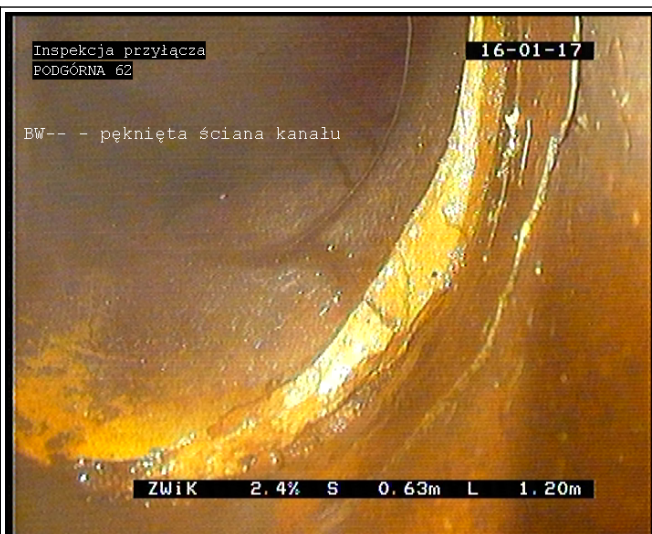
0.63 m - BW-- - pęknięta ściana kanału
