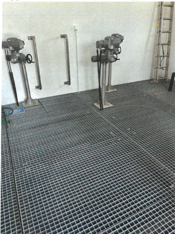
Zdjęcie nr 9. Pomieszczenie rurociągów
