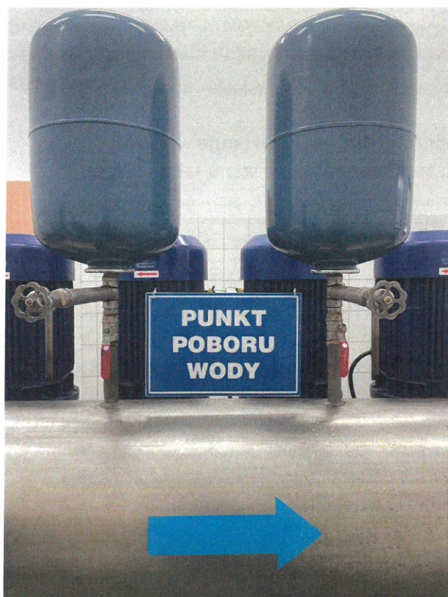
Zdjęcie nr 1. Punkt poboru wody czystej
